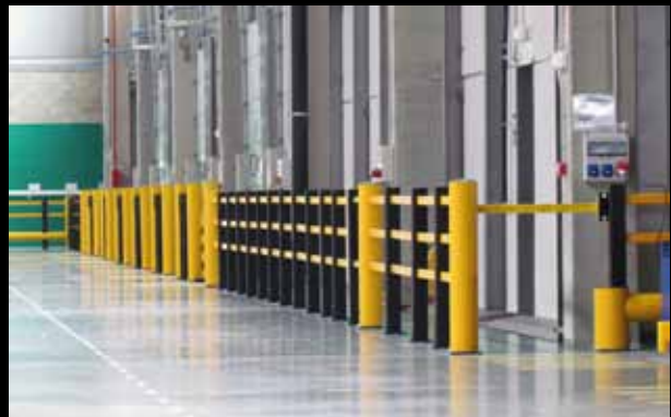
► HP Plus - BO Impact - Gate / entrepôt
